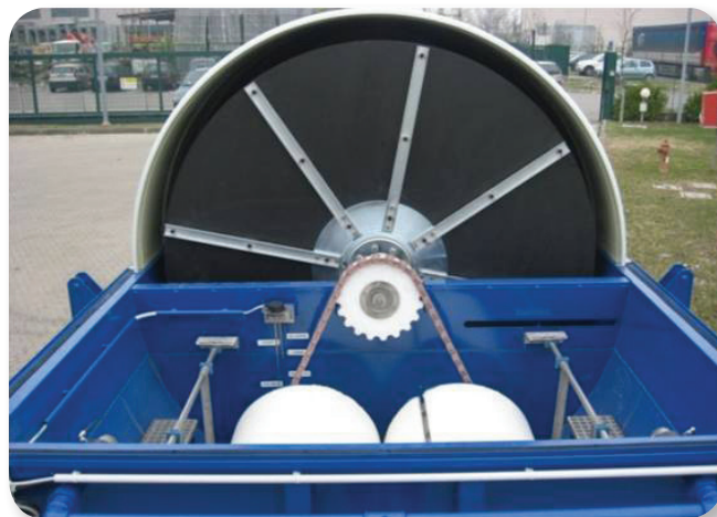
Vista interna del RBC y el filtro de medio textil filtrante de tambor.
